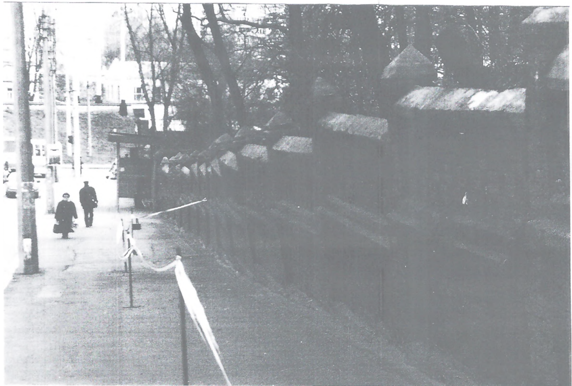
Фото 2. Крен ограды по нечетной стороне улицы на участке от ПК0+75 до ПК1+00
