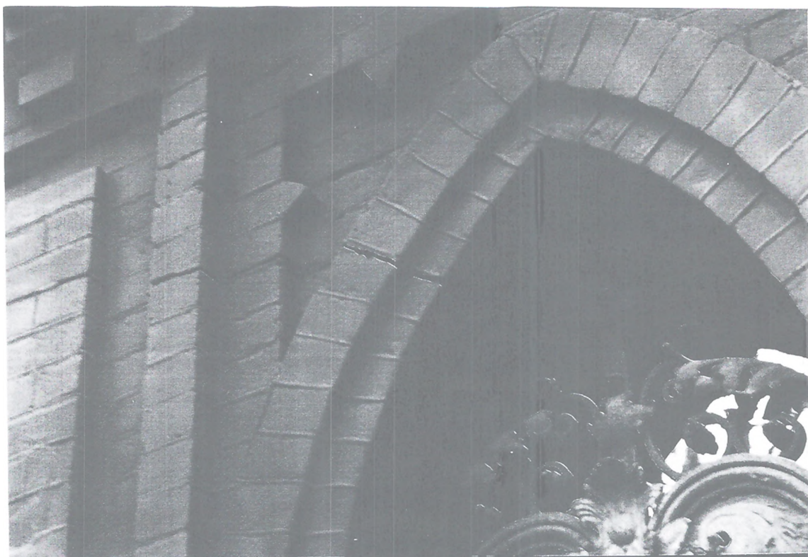
Фото 13. Трещина в правой арке ворот № 2
