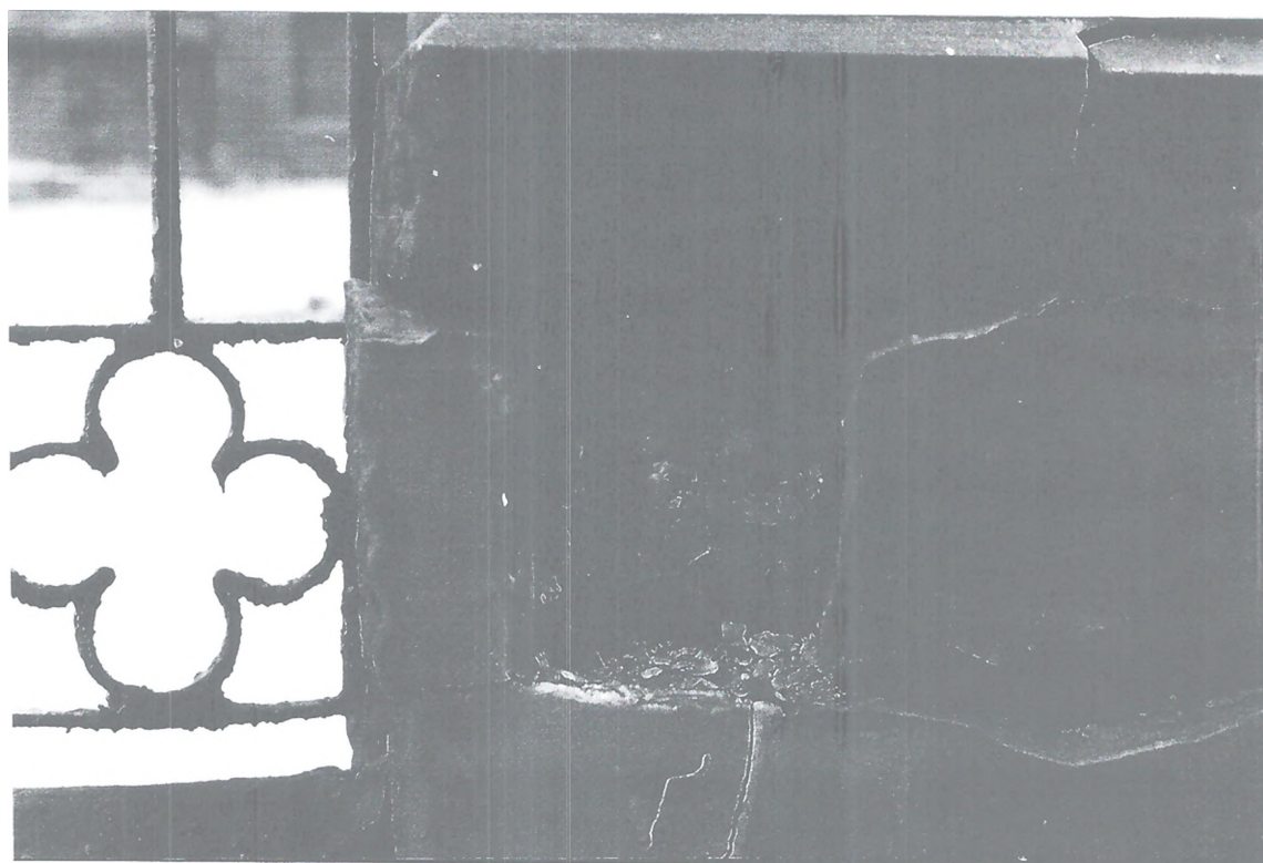
Фото 11. Состояние и материал столба, состояние металлической части ограды типа 2
