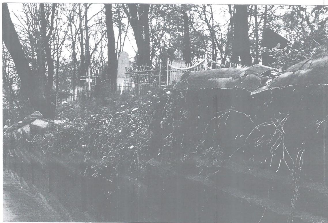
Фото 4. Разрушение кладки на участке от ПК1+35 до ПК1+56
