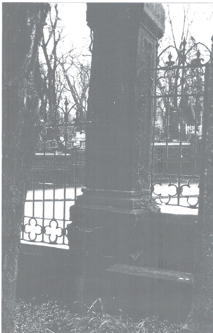
Фото 10. Вид столба, разрезанного трещинами, со стороны кладбища
