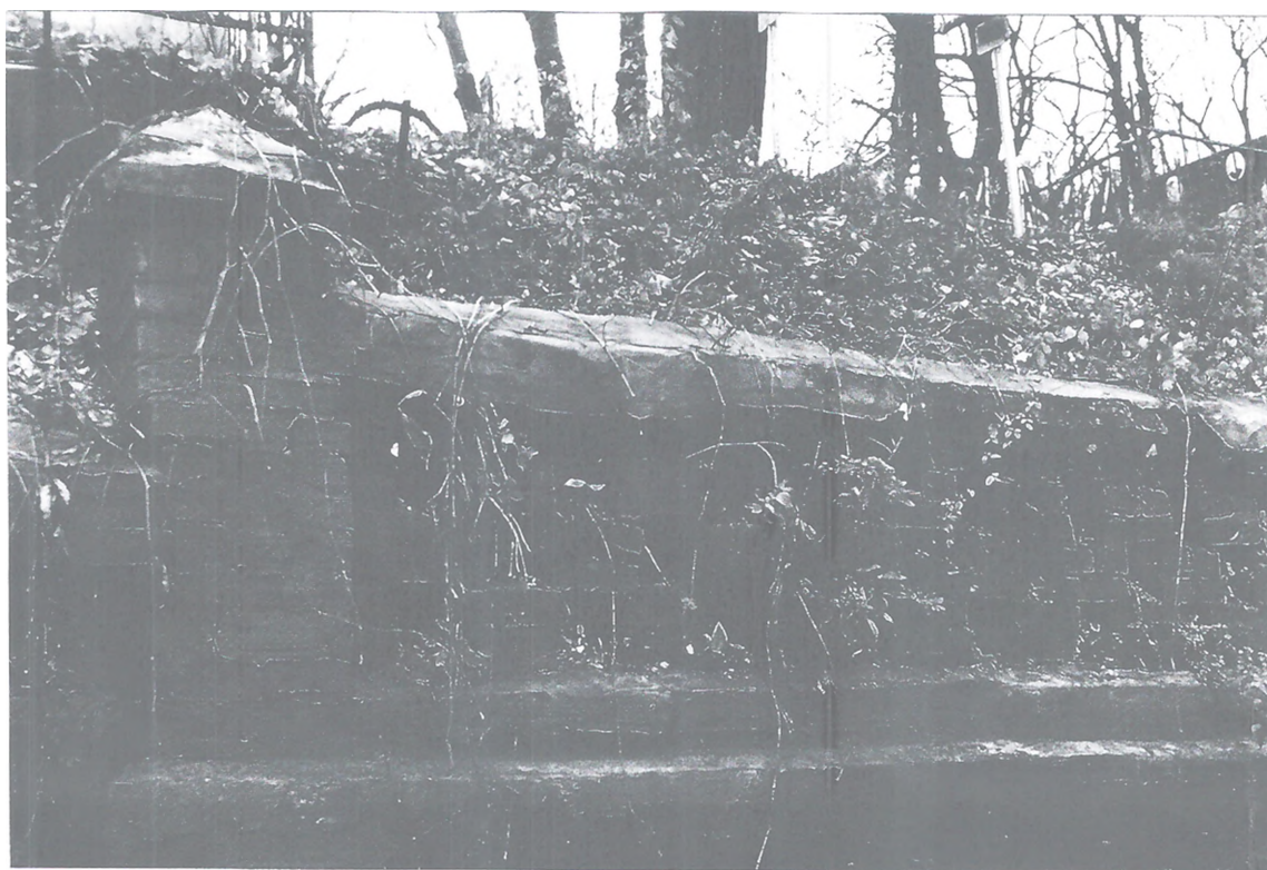
Фото 3. Горизонтальное смещение кладки. Следы разделки швов
